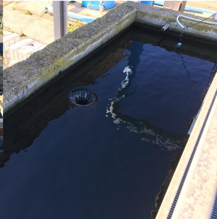
8.vasca raccolta acque filtrate
