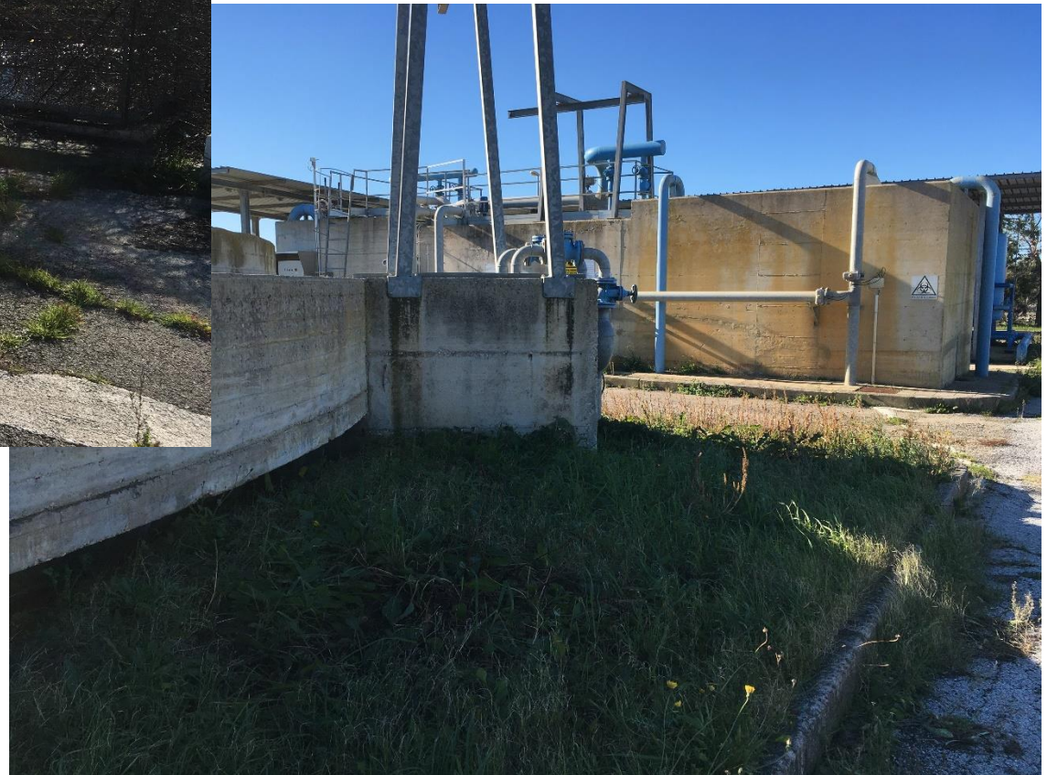
12 pozzetto sollevamento fanghi e vasca raccolta acque di lavaggio
