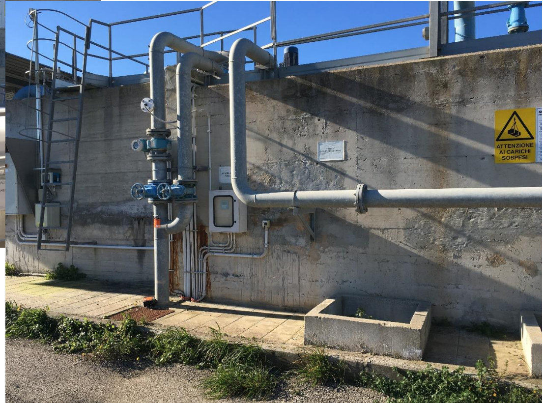
4. vasca di miscelazione veloce e carico chiariflocculatore
