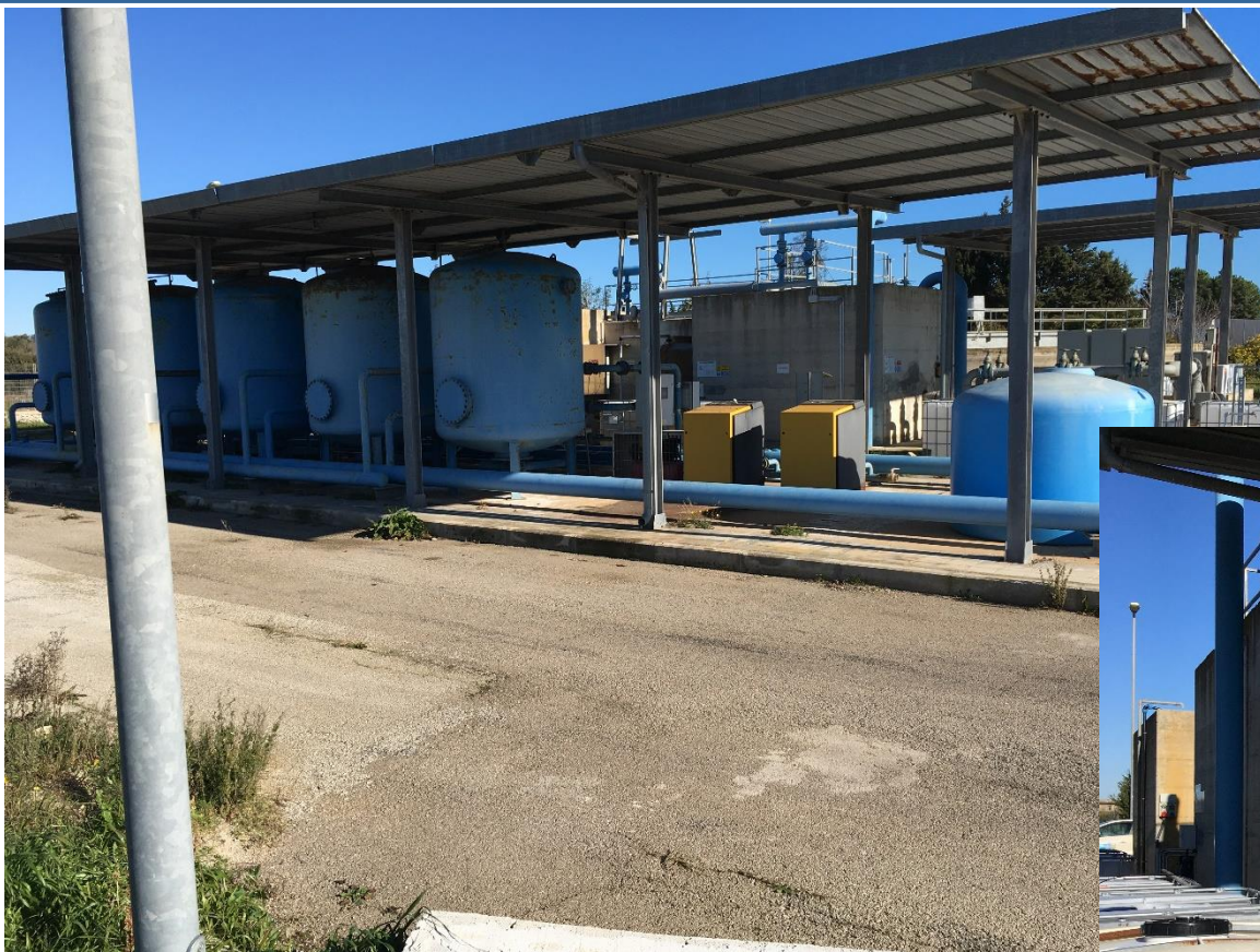
09 compressori per controlavaggio filtri
